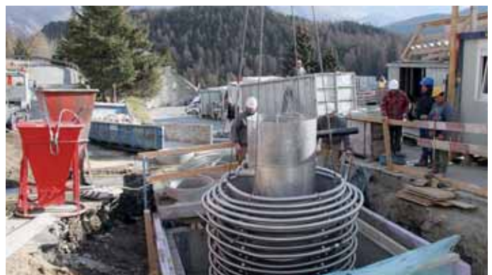
Dieser Abwasserschacht dient als Primärquelle zur Warmwasseraufbereitung.
